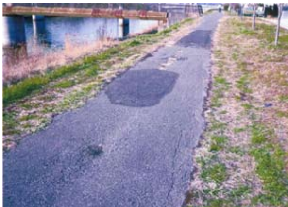
新川サイクリング道路。八千代運動公園対岸付近のサイクリングロードが特に荒れている。道幅も狭く、散
