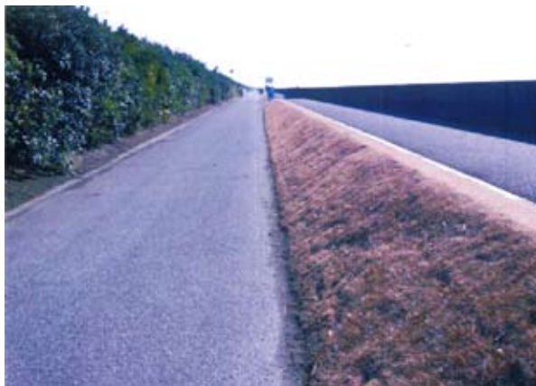
稲毛海岸沿いの工事現場（上側：歩道、下側：自転車道）。スタートのサイクリングコース（稲毛海岸沿い）は自転車と歩道を分ける工事が進んでおり、昨年より改善されている
