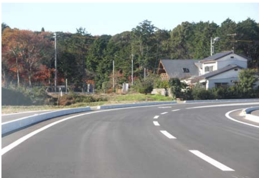
写真11 鹿行大橋の架け替えに伴って、国道も拡幅工事が進められている
