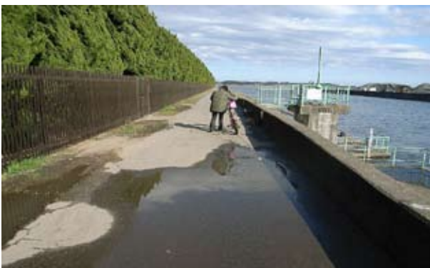
⑪ 全体に水はげが悪く、水たまりが続く
